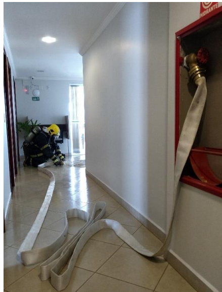
Ligação conectada do hidrante ao divisor
