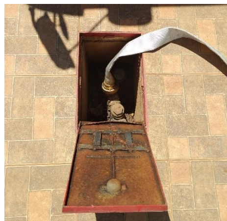
Hidrante de recalque com a ligação conectada
