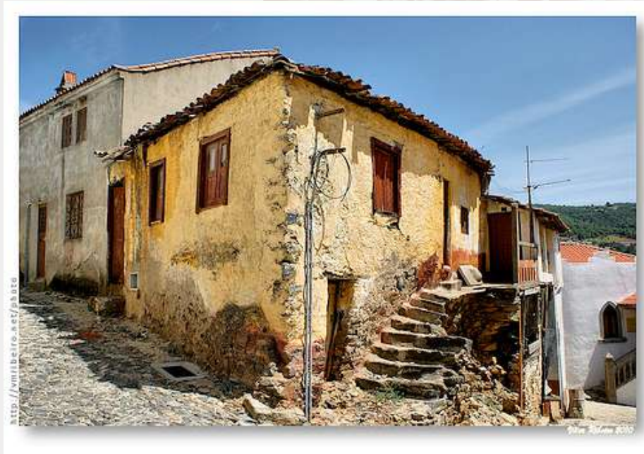
Figura 19 – Exemplo de dano nível moderado
