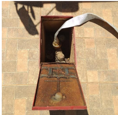
Hidrante de recalque com a ligação conectada
