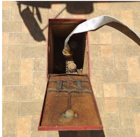
Hidrante de recalque com a adutora conectada
