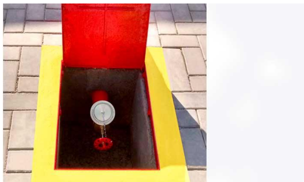
Hidrante de recalque
