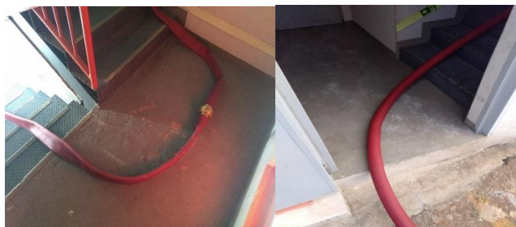
Adutoras estabelecidas na parte externa da caixa de escada
