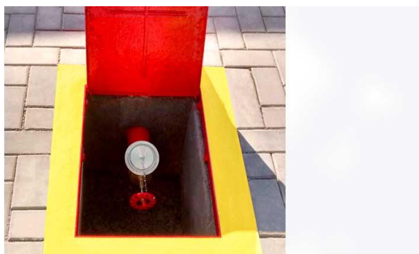
Hidrante de recalque
