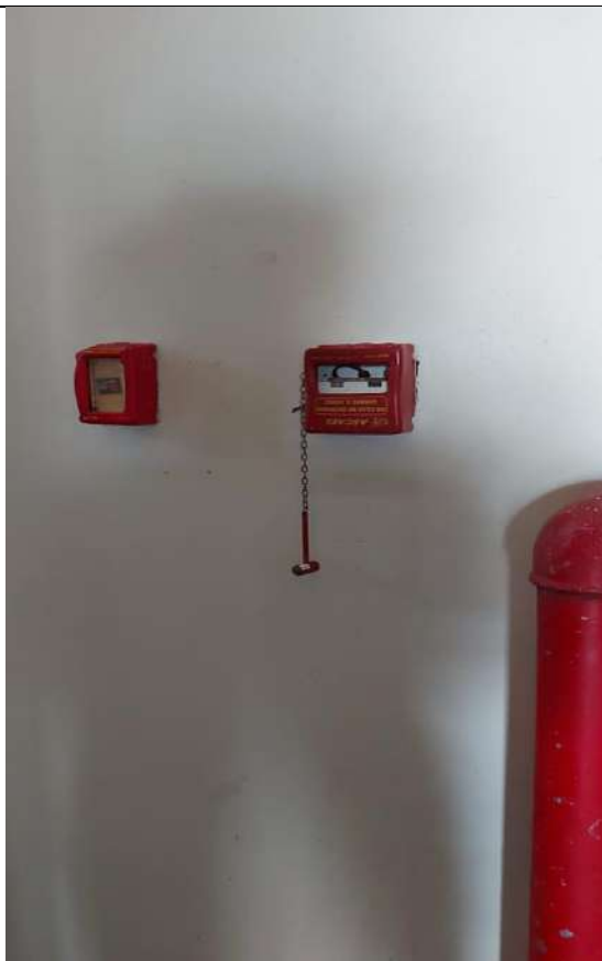
14 – Alarme de Incêndio inoperante
