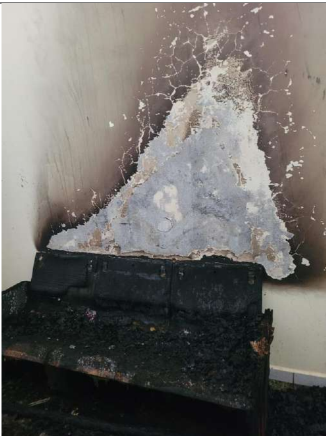
13 – Combustão do Sofá do corredor
