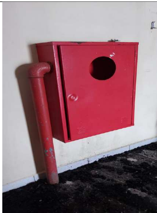
10 – Abrigo Hidrante de parede (inoperante)
