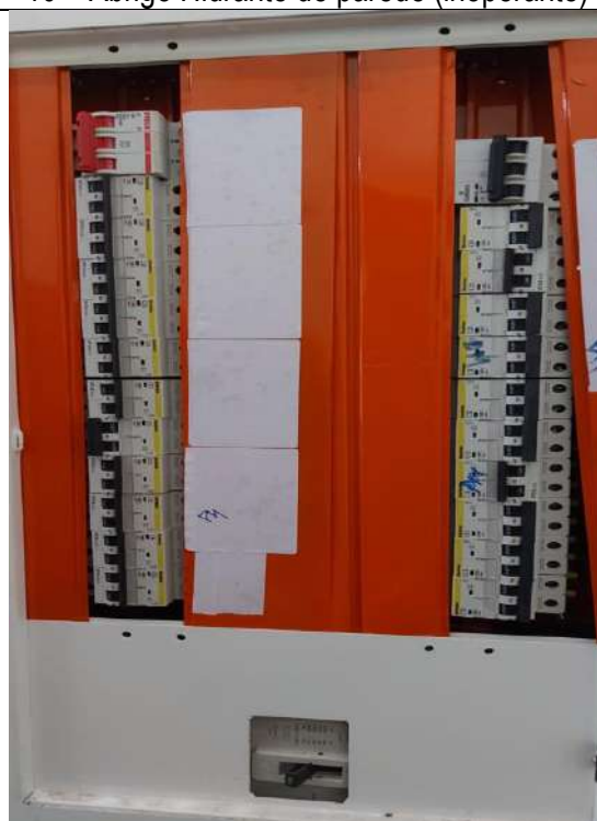
12 – Quadro de Distribuição de Circuitos
