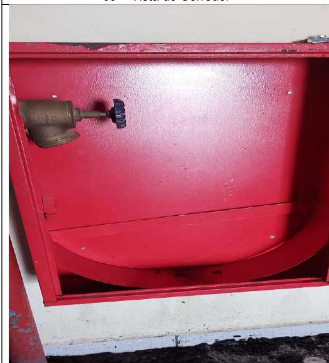
11 – Hidrante sem mangueira e esguicho
